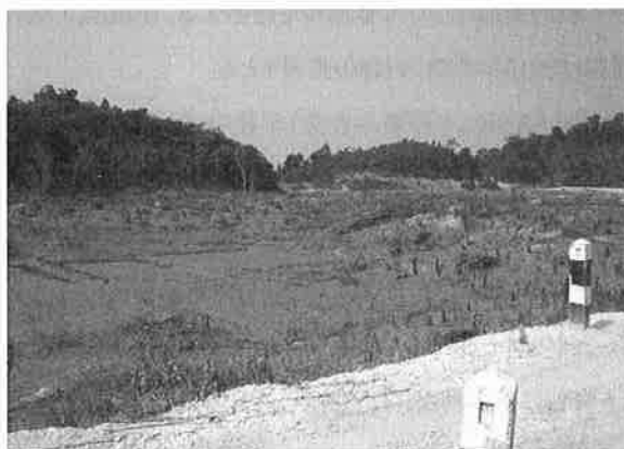
▲中国輸出入銀行が融資をして中国企業が建設したラオスのナムマン3ダム。灌漑用水路を引く調整池には施工ミスのせいか水が溜まっていない(2004年10月撮影、提供:メコン・ウォッチ)
