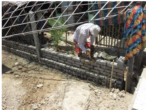
<希望する各世帯間に洪水対策用の敷居を設ける作業が進められている移転地（2015年5月）>
